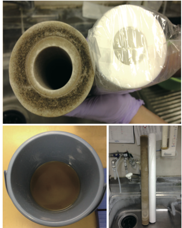
写真2 水道が泥水のため、真っ黒に汚れてしまったフィルター
