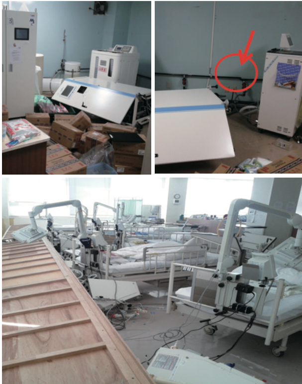
写真1 地震直後の散乱した透析室と機械室。右上の写真から配管が切れていることがわかる
