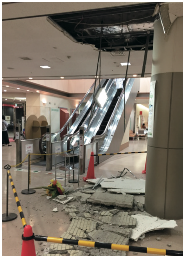
管理棟1階ロビー 天井崩落（前震後）
