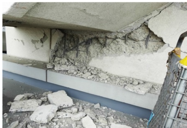
北館3F 外部階段下 壁コンクリート剥離（本震後）
