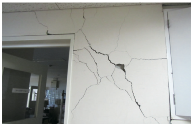
南館5F 内部壁せん断クラック（本震後）
